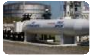
Іл. 36.11. Нафтоперекачувальна станція (Одеса – Броди)
