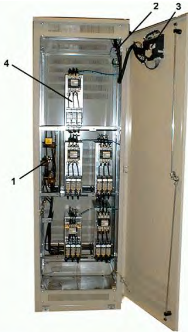
Рисунок 14.1 - Конденсаторні установки (батареї) з автоматичним регулюванням, підлогове виконання
